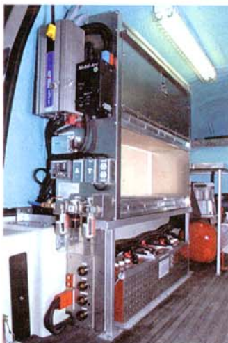
● L'une des unités de Mobil-Tech comportant toute l'énergie électrique nécessaire pour une multitude de travaux.
